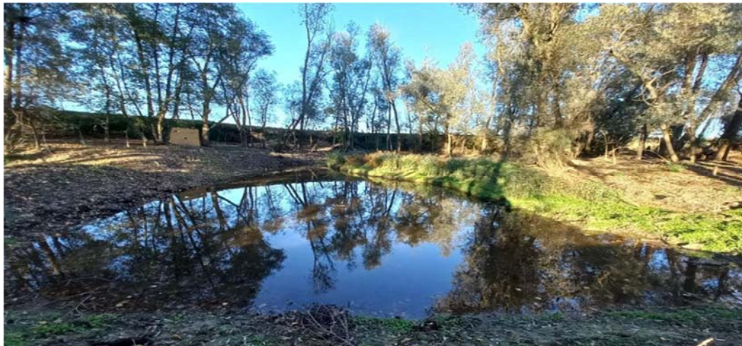
Figura 24. Situazione a fine lavori presso l'Oasi "Bodrio Le Margherite di San Daniele po (CR): con scavo e l'affissione di tubi per il superamento dello strato di argilla, l'acqua comincia ad affluire e a riempire l'invaso (8/10/2022).
