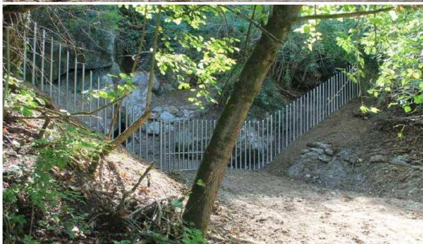
Esempi di cancellate (Life08 NAT IT000369 Gypsum)
