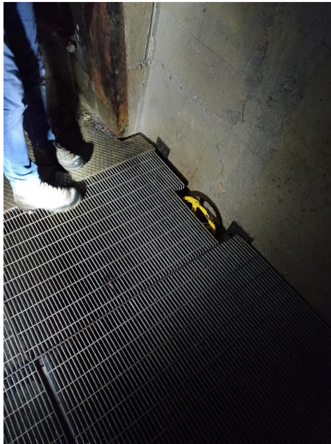
Spillamento - Finestra VI
