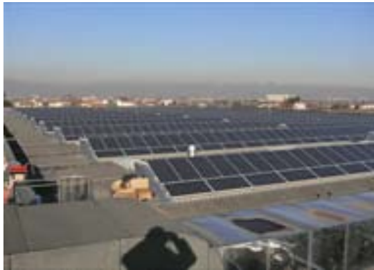
Fig 68. Le installazioni sulla parte a sud degli shed industriali permettono una buona integrazione del fotovoltaico all'interno dell'edificio e ne sfruttano una parte inutilizzata. ( www.ensun.it )
