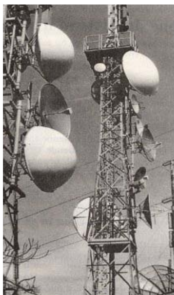
Fig 99. Stazione radio base mista (Consorzio Radio Elettra2000)
